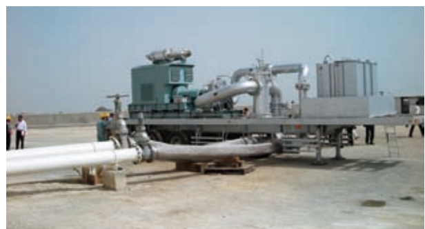
ディーゼルエンジン駆動循環ポンプ (ポンプは移動可能となっている。)
