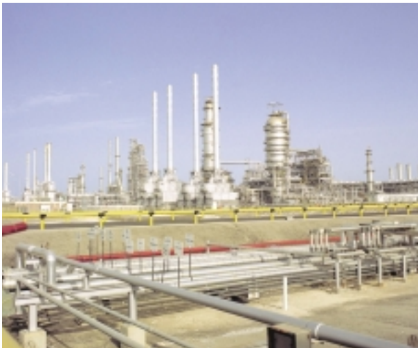
ラストヌラ製油所
