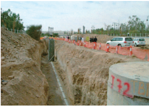
アルインでの下水配管工事（埋設前の配管とマンホール）
