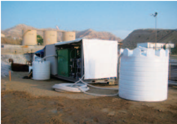
水処理装置の全景
