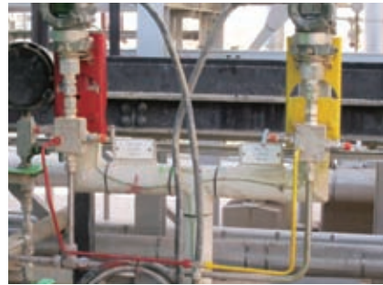
圧縮機周り改善後
