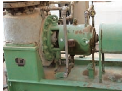
ポンプ改善前
