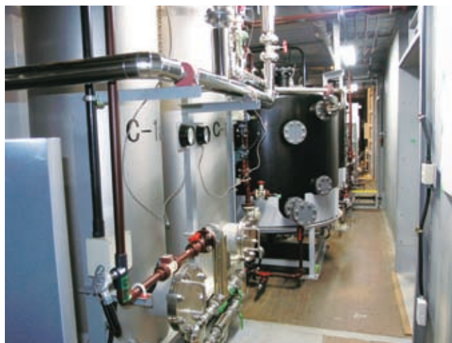
廃水処理パイロットプラント
