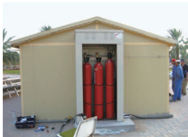
水素ボンベ室
